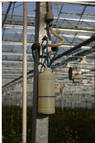
Fot. 43. Zbiornik na stężoną ciecz do aerozolowania
