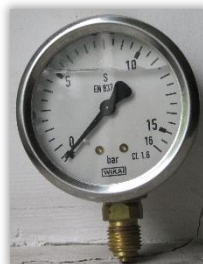
Rys. 52. Manometr ze zbyt mało dokładną podziałką (do 5 bar) – skala w barach.
